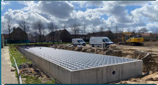
Ondergrondse buffer Kerelsplein Roeselare
